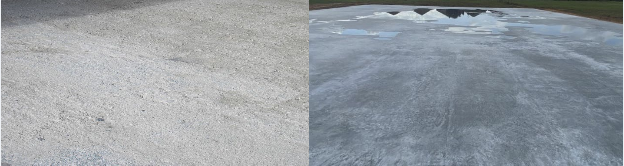
Şekil 1. Yağmurlu havada beton dökümü yapılan zeminlerde yüzey hasarı
