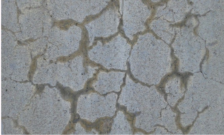
Şekil 1. Alkali-silika reaksiyonu sonucu oluşan harita çatlakları
