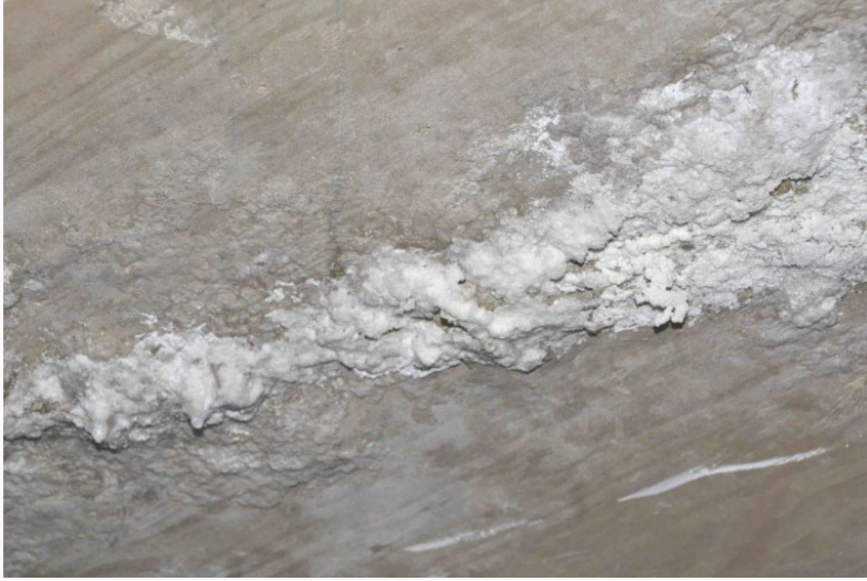
Şekil 3. Beton yüzeyinde sülfat etkisi sonucu hasar oluşumu
