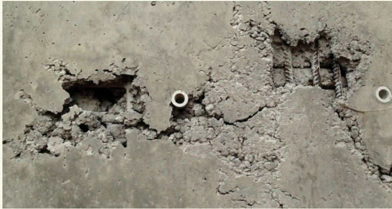
Şekil 6. Beton yüzeyinde petek dokusu oluşumu
