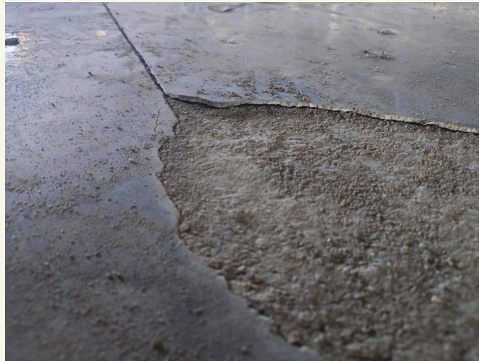
Şekil 5. Beton yüzeyinde tabakalaşma
