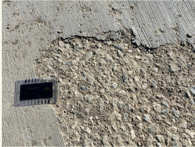
Şekil 7. Beton yüzeyinde kabuk atma
