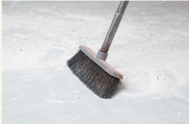
Şekil 11. Beton yüzeyinde tozuma
