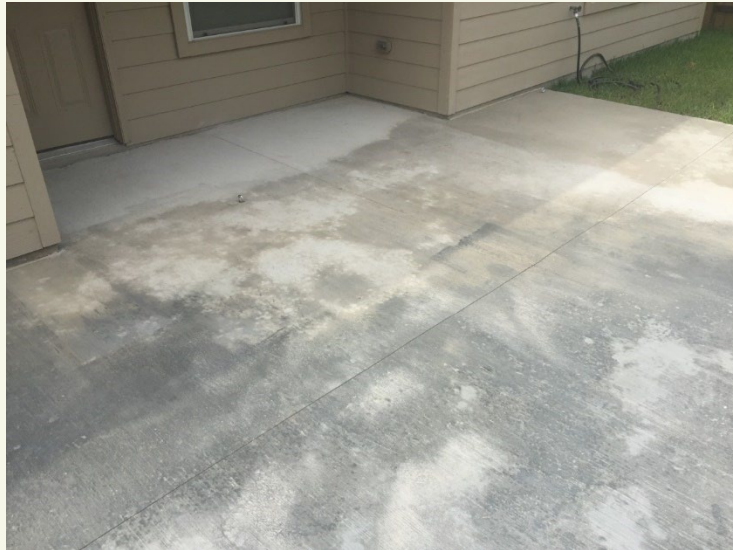
Şekil 10. Beton yüzeyinde renk düzensizliği
