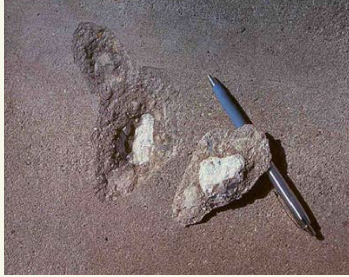
Şekil 12. Beton yüzeyinde parça atması
