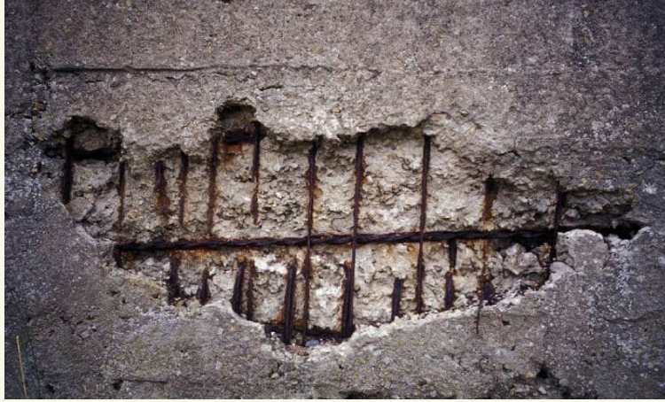
Şekil 8. Beton yüzeyinde dökülme
