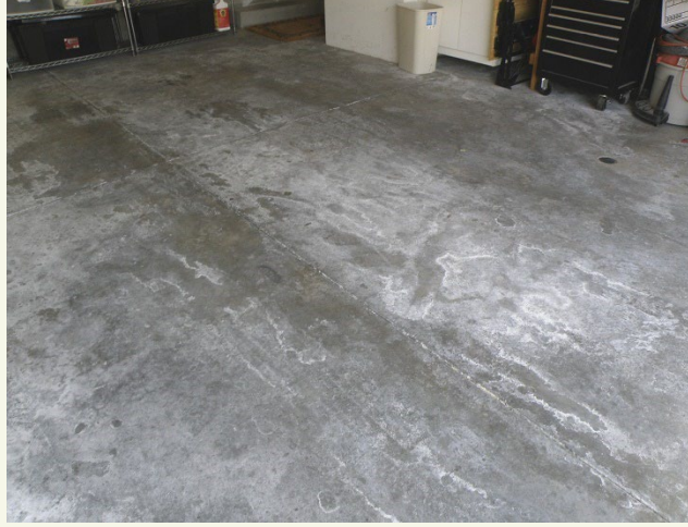
Şekil 9. Beton yüzeyinde çiçeklenme
