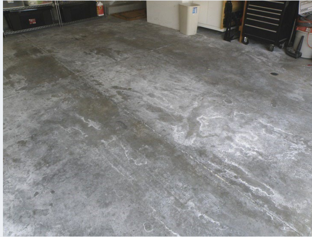
Şekil 1. Beton yüzeyinde çiçeklenme
