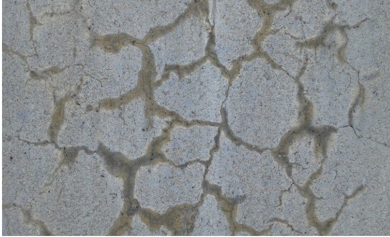
Şekil 15. Alkali-silika reaksiyonu sonucu oluşan harita çatlakları
