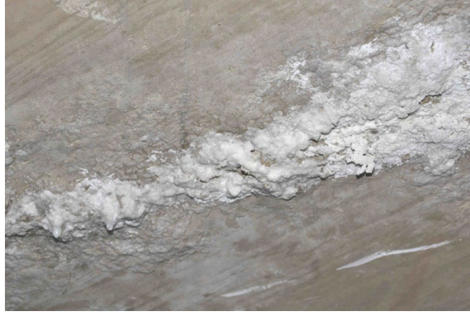
Şekil 14. Beton yüzeyinde sülfat etkisi sonucu hasar oluşumu
