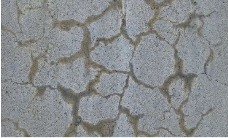
Şekil 15. Alkali-silika reaksiyonu sonucu oluşan harita çatlakları
