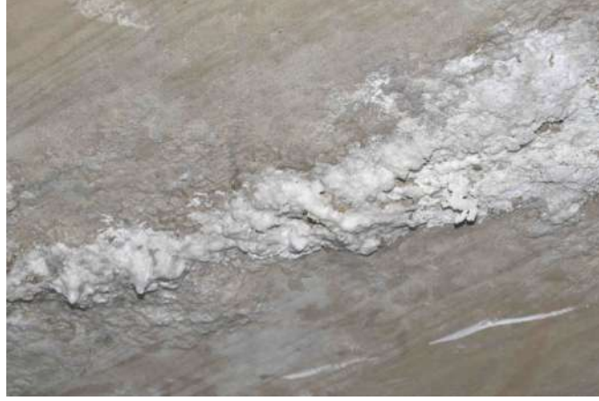
Şekil 14. Beton yüzeyinde sülfat etkisi sonucu hasar oluşumu
