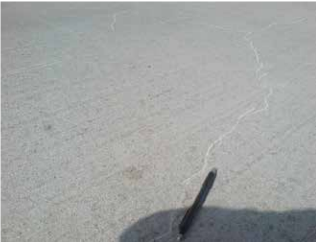
Şekil 2. Plastik rötre çatlakları
