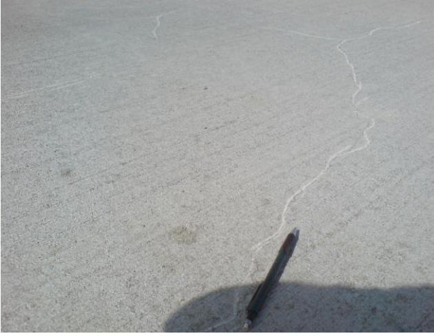
Şekil 2. Plastik rötre çatlakları
